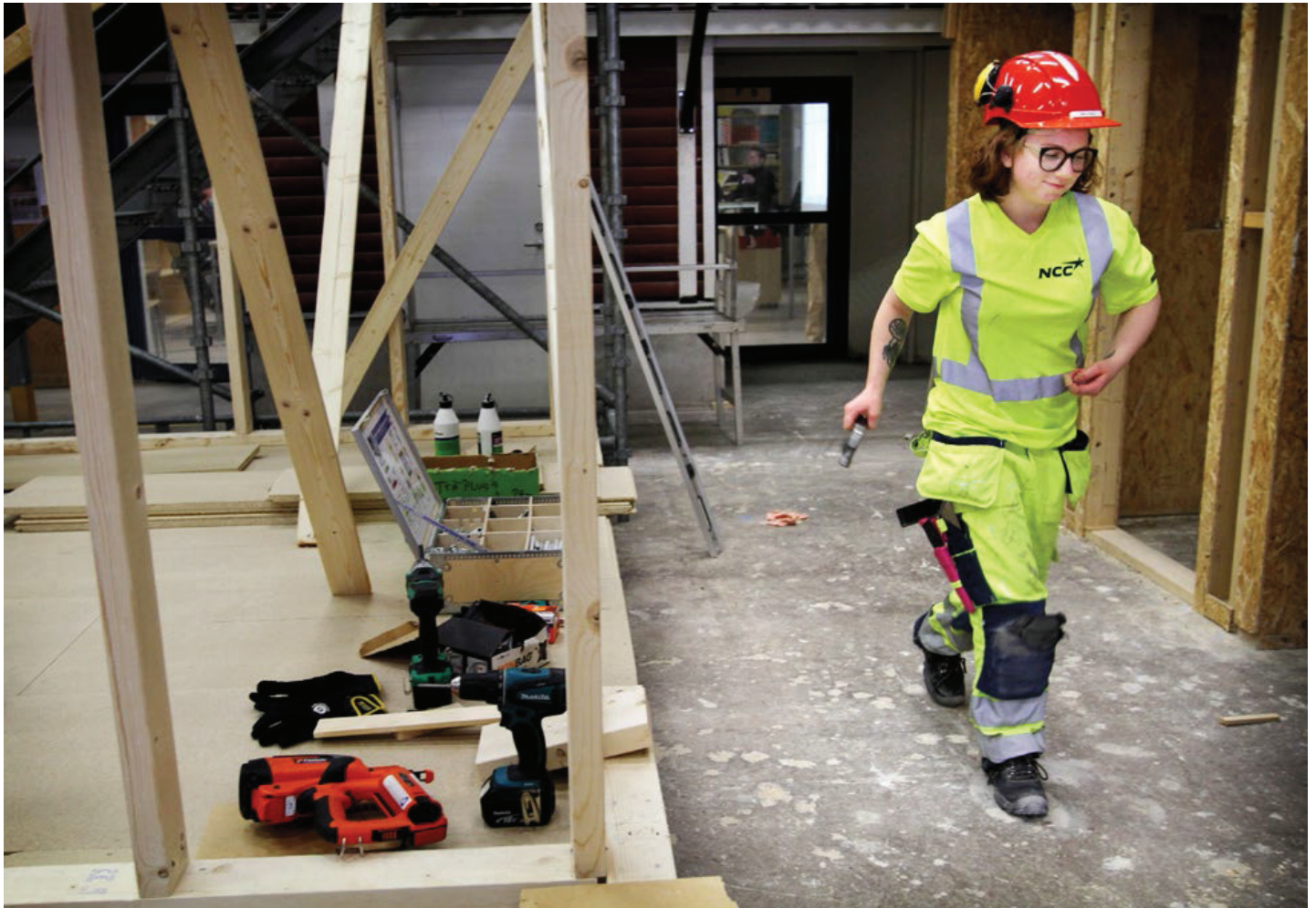
Malin Lindberg går i årskurs tre på Vadsbogymnasiets bygg- och anläggningsprogram. Ett val hon aldrig ångrat.
